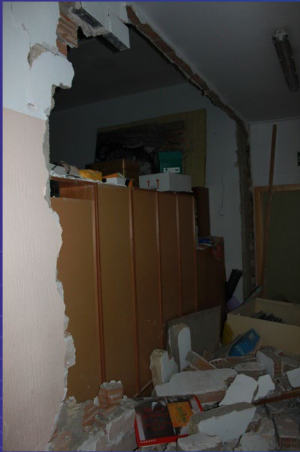
Rupture hors-plan au rez-de-chaussée d'un collège à proximité de la sortie
